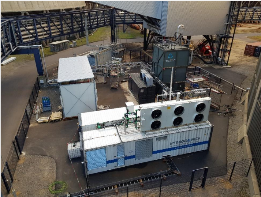
MefCO 2 pilot plant, Niederaussem
